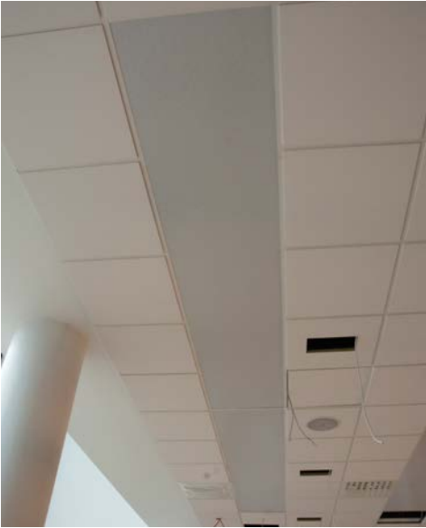
Alumiinirakenteinen HKE säteilijä alakatossa
