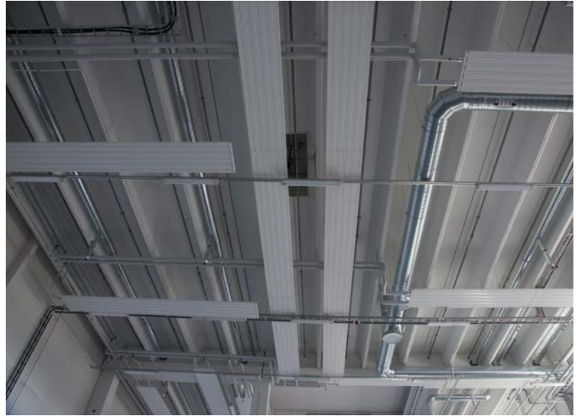
Teräsrakenteinen Eco säteilijä, likööritehdas Kuopio
